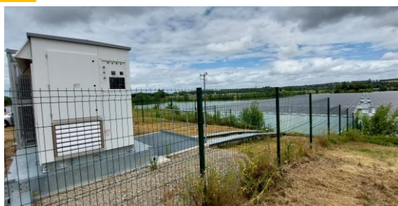
Transformateur, onduleur et station météo
