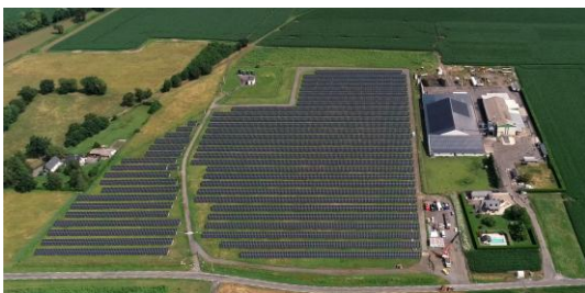
Vue aérienne du parc photovoltaïque
